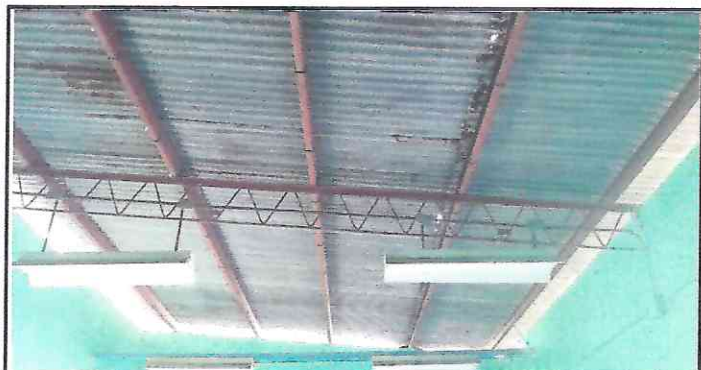
Foto 3: Cubierta en mal estado
