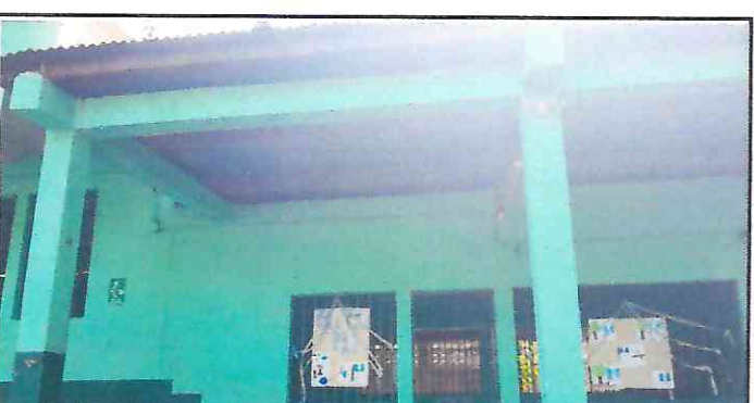
Foto 6: Cubierta en mal estado
