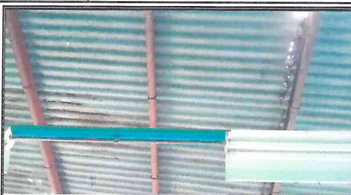
Foto 2: Cubierta en mal estado
