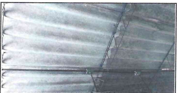
Foto 5: Cubierta y estructura en mal estado
