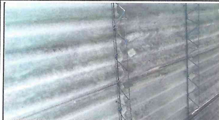
Foto 1: Cubierta en mal estado
